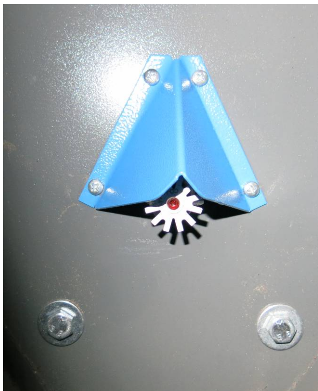
а) система пожаротушения в бункере
